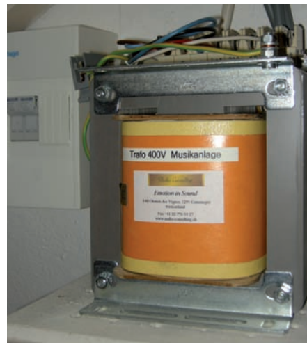
Der grosse zentrale Trenntrafo im Keller
